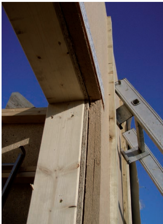
L'enveloppe de la maison est ici renforcée grâce à l'isolation extérieure (fibre de bois de 40 mm d'épaisseur).
