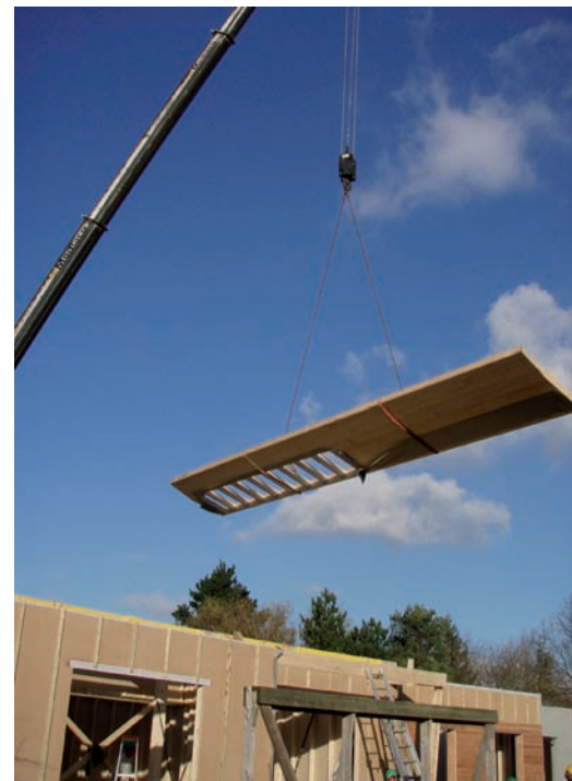
La performance d'isolation de la maison de Patrick repose sur sa structure même. Il s'agit d'une ossature bois en panneaux.
